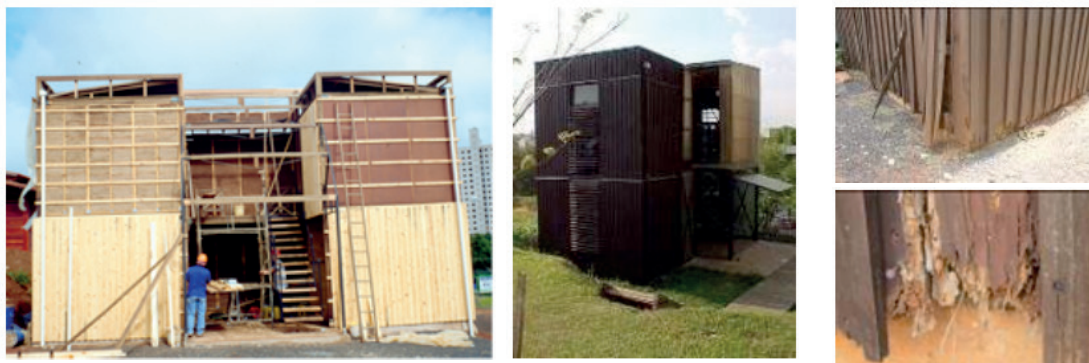
Figura 1: À esquerda: Unidade 002 na etapa de execução do revestimento; Centro: Unidade 002 hoje; Direita: Atual situação do revestimento.
