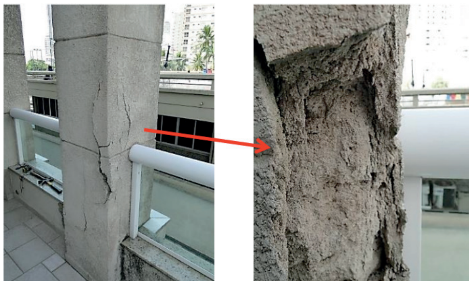
Figura 1 – Sintomas observados: expansão e fissuração com esfarelamento do sistema de revestimento das fachadas.
