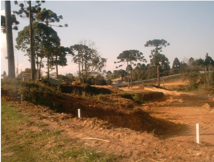
Foto 1 - Área destinada a edificação: desmatamento, movimentação de terra, destruição das formas originais do relevo e do solo orgânico.
