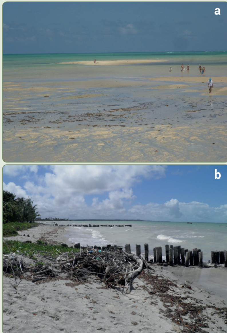
Figura 5.2 – Estrutura de contenção à erosão feita de tronco de coqueiro na Praia de Carne de Vaca
