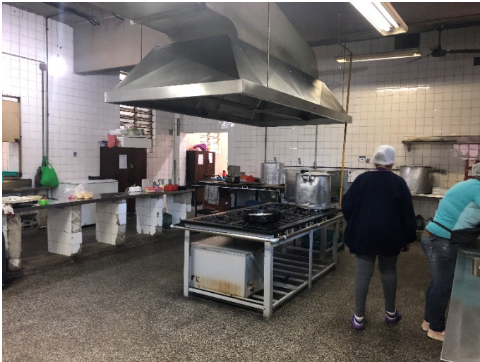
FIGURA 3 – Cozinha para preparo das refeições das presas Fonte: a autora
